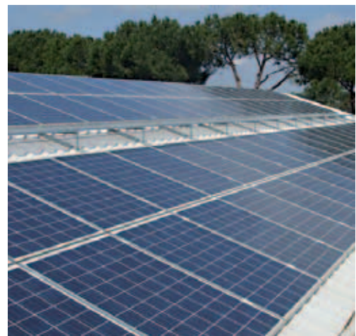
L'impianto sul tetto del punto vendita
