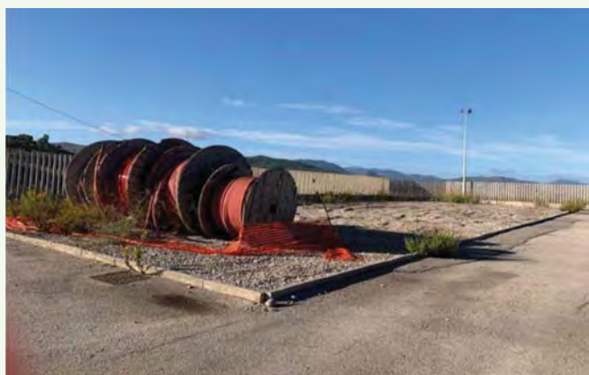
Area di installazione nella sottostazione
